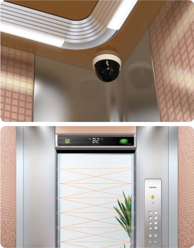
블랙박스형 CCTV / 멀티빔 출입문 안전장치
